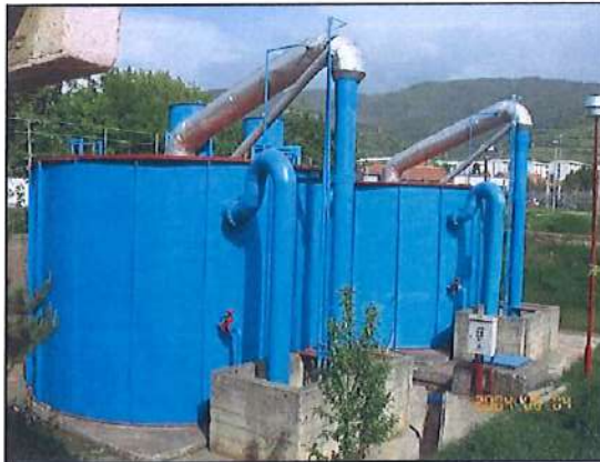
Figura 8: Filtrimi, fabrika për përpunimin e ujit të pijshëm
